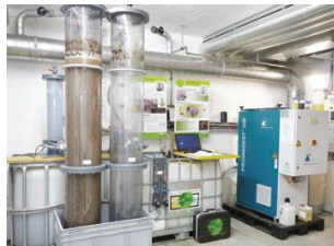
Local de traitement Eawag (photo: Projet VUNA), sont visibles les colonnes de nitrification, le distillateur et des cuves de stockage
