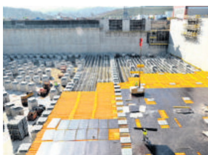
La fosse du réacteur en cours de construction, avec ses 493 piliers d'isolation sismique. DR
