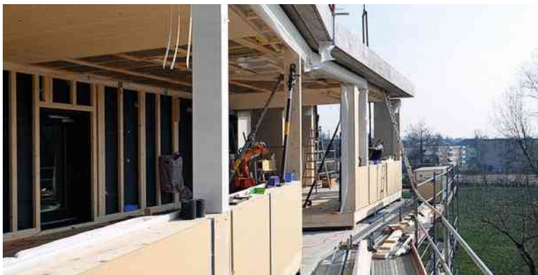
Mit dem zurzeit im Bau befindlichen Projekt «SolAce» werden farblich aufeinander abgestimmte Sonnenkollektoren und PV-Module zusammen als Hybridfassade im Forschungsgebäude NEST demonstriert. (Bild: Empa)
