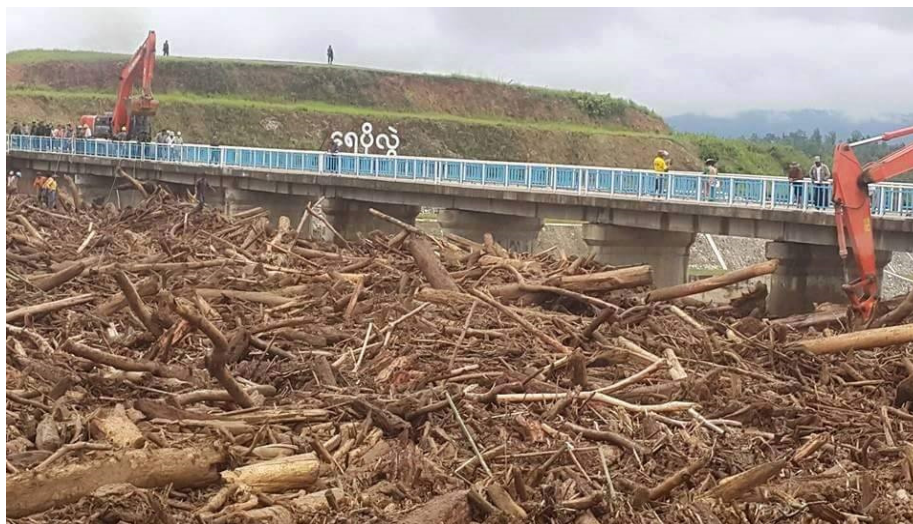
Figure 1: Image de le deversoir bloquee a cause de bois flottant ( http://www.thutatuam.net ).
