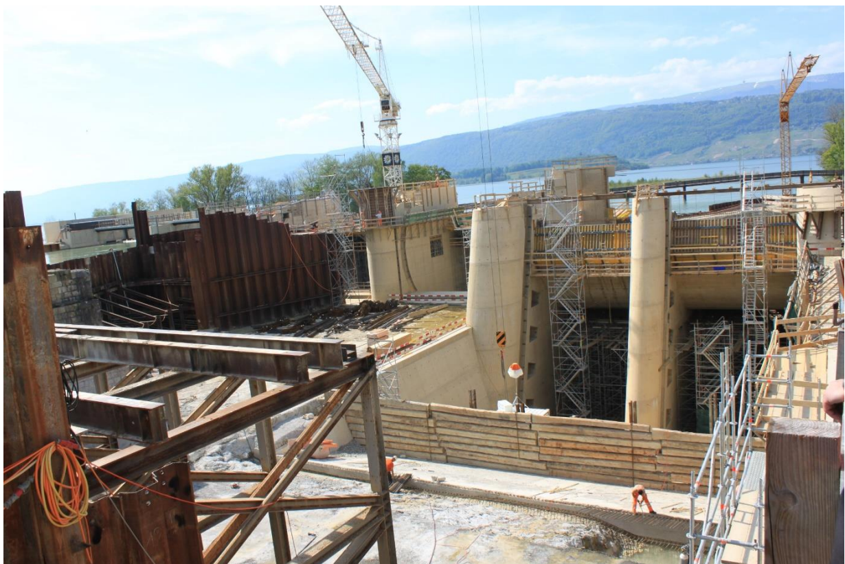
Vue depuis l'amont du chantier l'entrée des deux turbine après le bétonnage de l'usine
