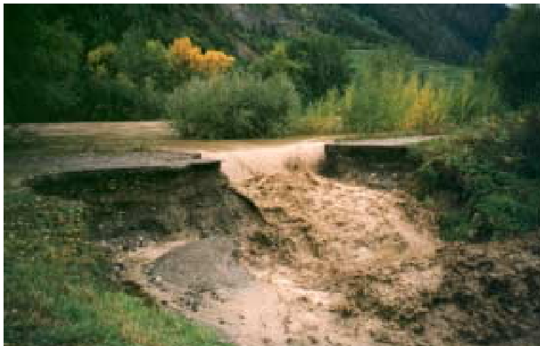
Fig 1 : Rupture de la digue à Chamoson le 15 octobre 2000 (Source : www.bwg.admin.ch ) Failure of the Chamoson dam on 15 th October, 2000 ( www.bwg.admin.ch )
