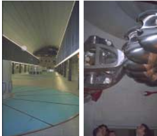
Aménagement hydroélectrique de Cleuson-Dixence: salle des machines (à gauche) et roue de la turbine Pelton (à droite) Hydroelectric scheme Cleuson-Dixence: machine hall (on the left) and Pelton turbine runner (on the right)
