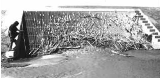
Fig. 1. Grille de rétention des corps flottants de la prise d'eau.
