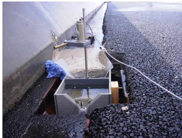
Figure 2: Système de mesure du débit de drainage muni d'un déversoir triangulaire et d'un limnimètre à ultrasons
