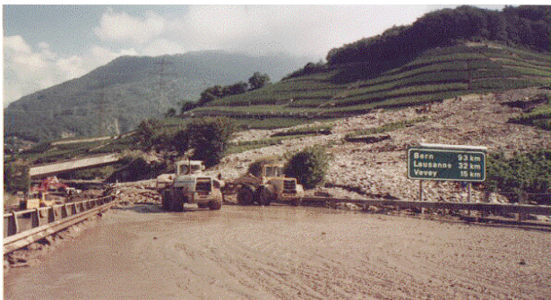
Fig. 1 : Vue des travaux de déblaiement sur la RN9 après la coulée d'août 1995.
