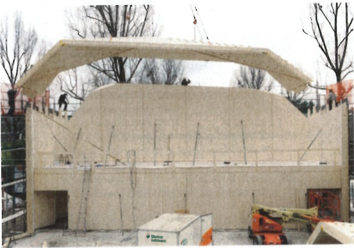
← Le nouveau Pavillon du Théâtre de Vidy est une structure plissée conçue à partir de panneaux en bois. Ce volume est constitué d'onze porteurs d'environ 2,6 m de large. Image : IBOIS
